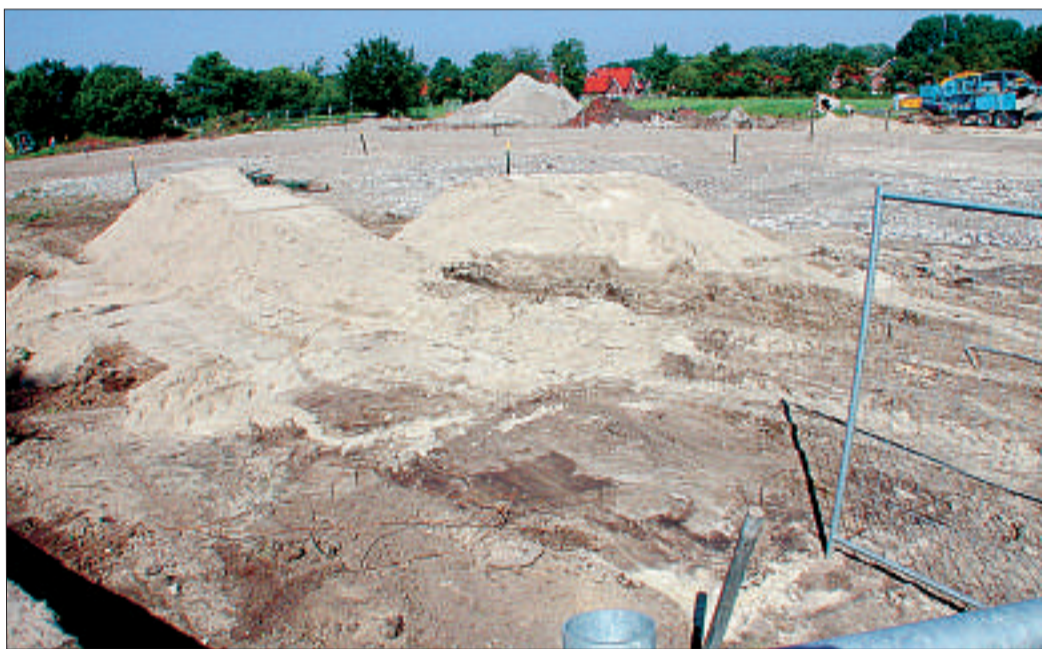
Die Rekultivierung des alten Klärwerksgeländes in Hage läuft noch auf Hochtouren. FOTO: FRANSEN
