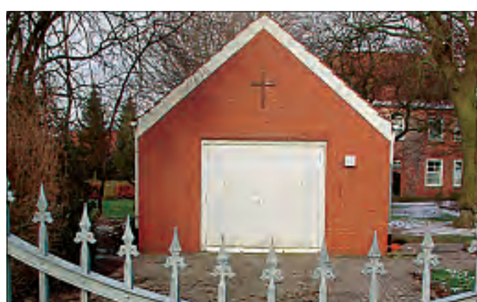
In schlechtem Zustand: die Dornumer Leichenhalle.
